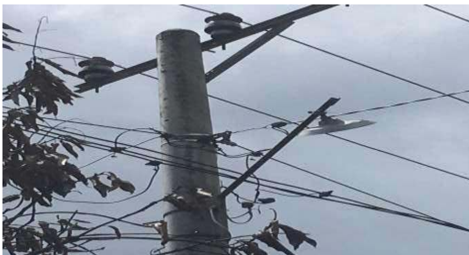
Gambar 22. lampu penerangan jalan
